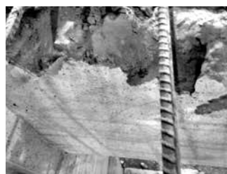
Vết nứt xuất hiện phía đầu dầm
